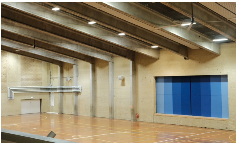
Høng Hallen med to NORDICCO-loftventilatorer
