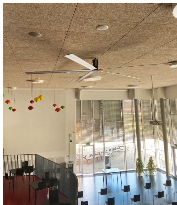
Høng Skole med den nye loftventilator
